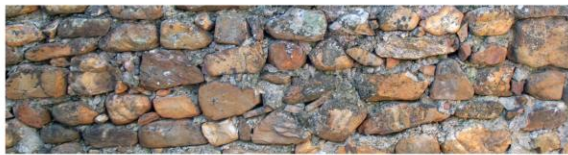
Detalle del aparejo en el refugio de tropas. Bonding detail on the troops dugout's wall.
